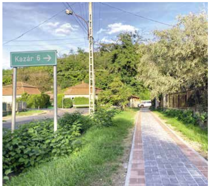
Új járda épült a Csokonai út és a Nagymező út közötti szakaszra.
